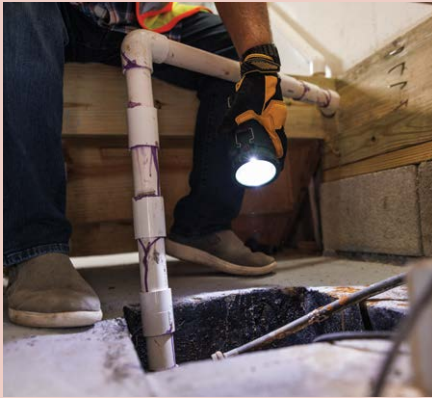
FOSSE MOTEUR INONDÉE
